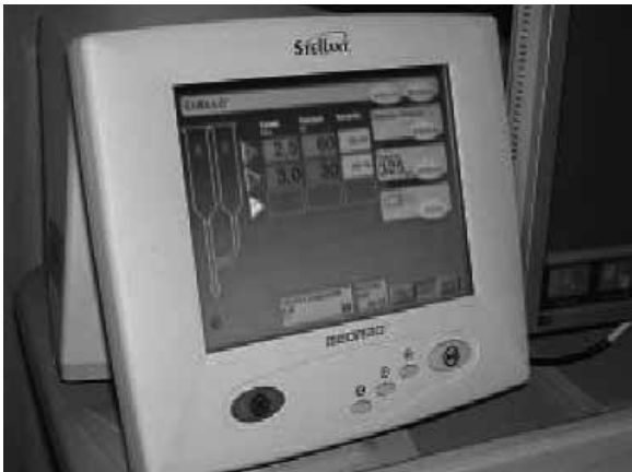
Foto 4: Monitor del inyector eléctrico situado en la sala de control del gantry.
