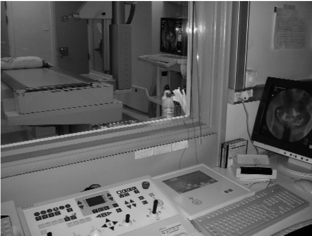
Imagen 2: Telemando y sala de RX
